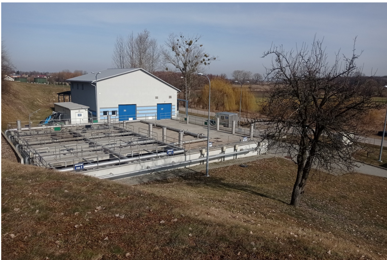
Zdjęcie nr 18. Oczyszczalnia Ścieków w Werbkowicach – reaktory biologiczne, budynek techniczny.
