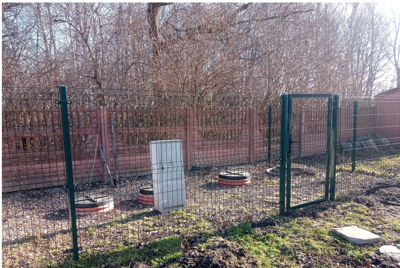
Zdjęcie nr 22. Biologiczna Oczyszczalnia Ścieków – Hostynne Świetlica.
