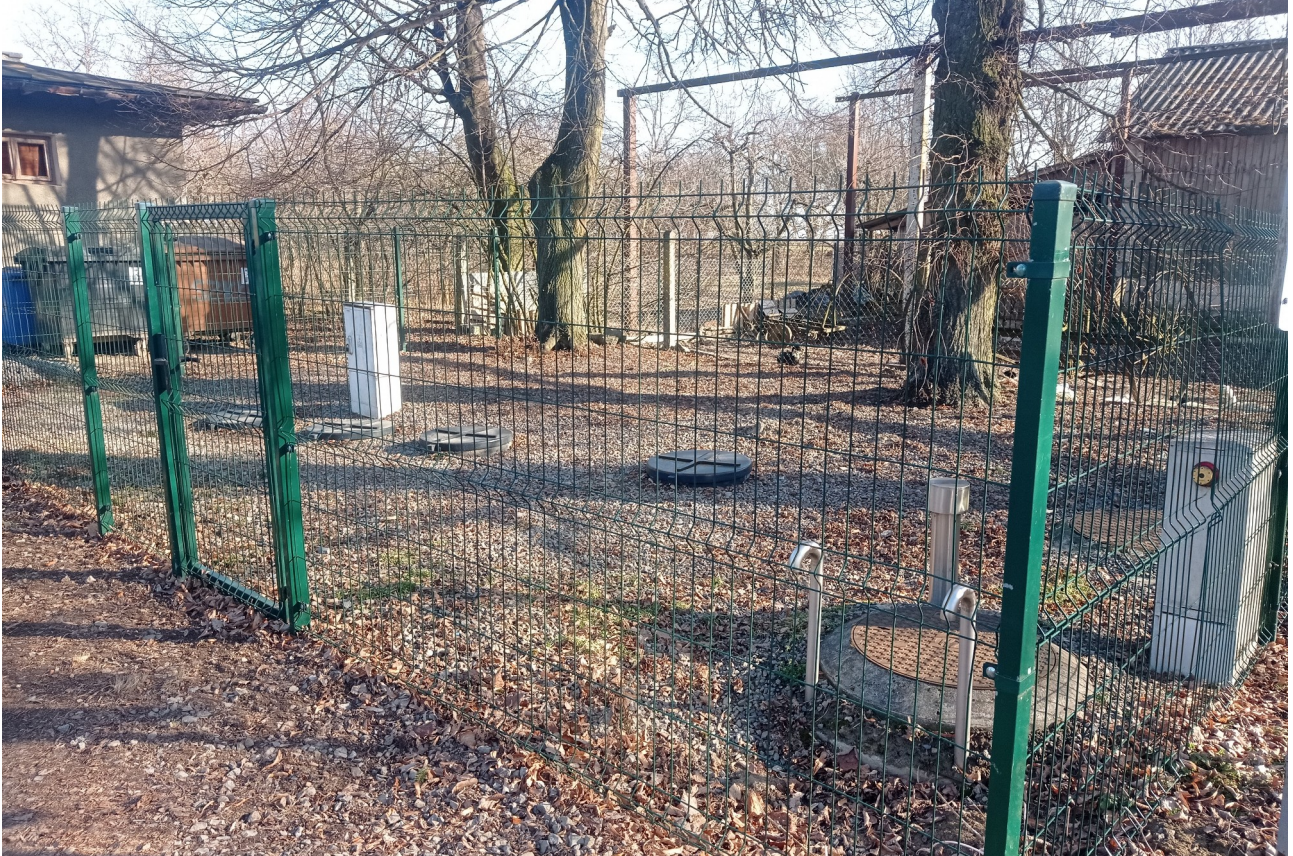
Zdjęcie nr 22. Biologiczna Oczyszczalnia Ścieków – Hostynne-Kolonia Szkoła Podstawowa.
