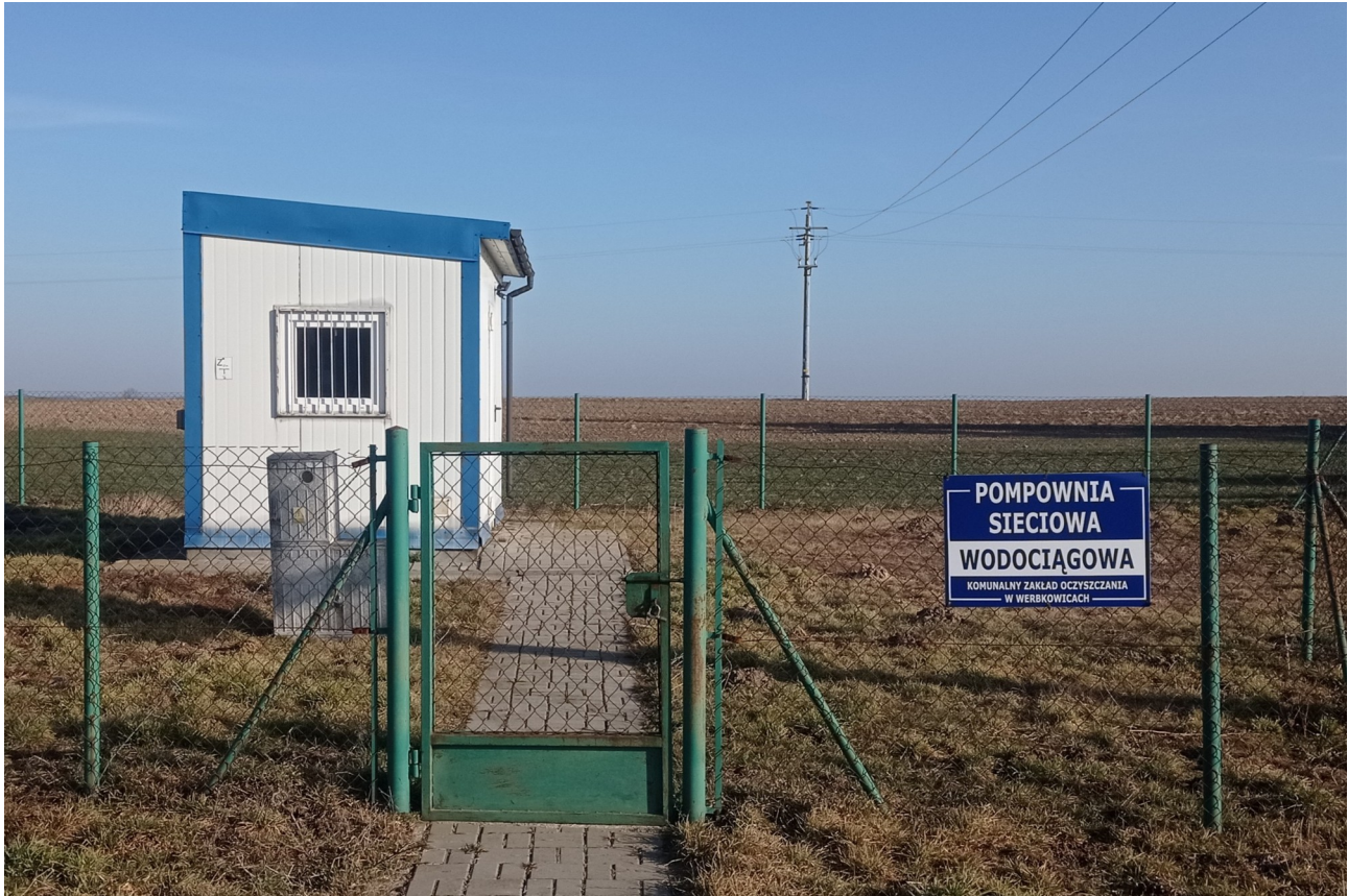
Zdjęcie nr 9. Pompownia sieciowa wody – Alojzów.
