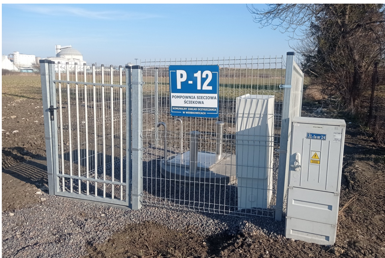
Zdjęcie nr 20. Przepompownia Ścieków ul. Zamojska.
